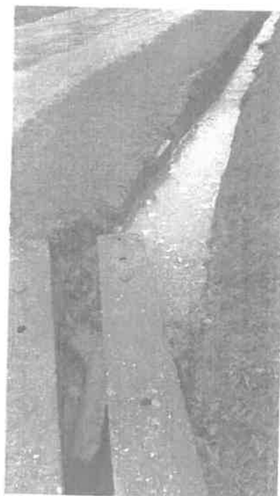
Beszakadt úteresz (Ady Endre utca)
