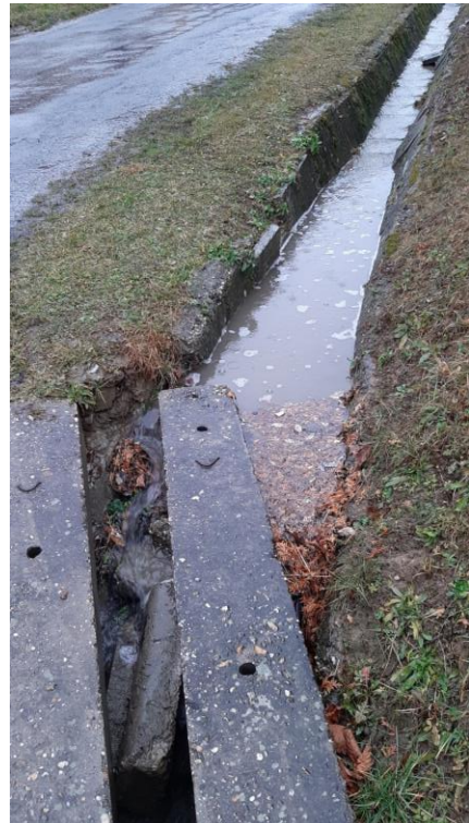
Beszakadt átereszt (Ady Endre utca)
